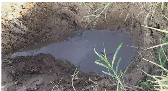
Слика 3. Трагови тешких оштећења насипа
