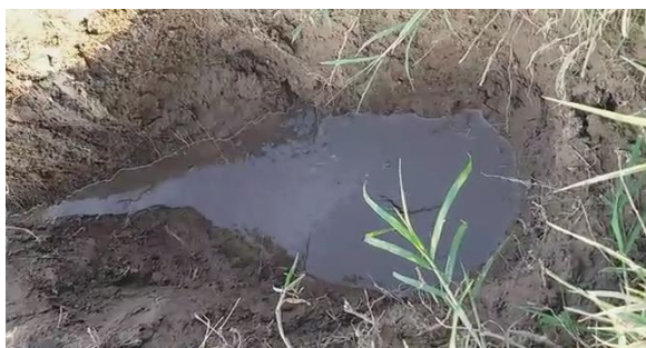
Слика 3. Трагови тешких оштећења насипа
