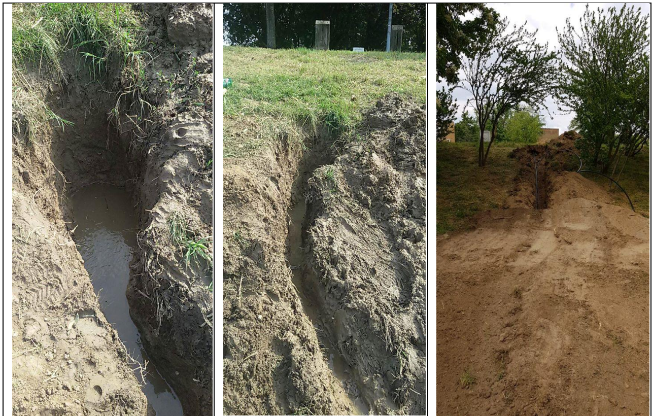
Слика 2. Оштећење насипа ископом; слева у десно: илегално постављена цев за довод воде до сплава је оштећена, што је расквасило и угрозило труп насипа – неопходна је санација на одређеној деоници; ископ ради постављања водоводне цеви и импровизовано затрпавање ископа – место потенцијалног пробоја насипа
