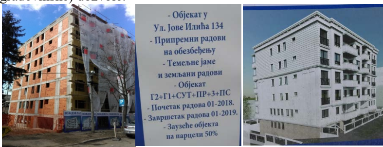
Slika 2. Obјekat u Jove Ilića - izgrađena dva sprata više od dozvole
