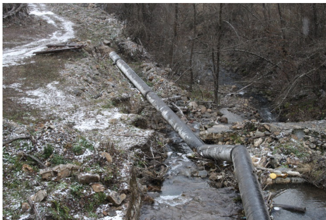
Slika 3: Uništen zub slapišta na deponijsko-konsolidacionoj pregradi br. 2 (MHE „Zvonce“)
